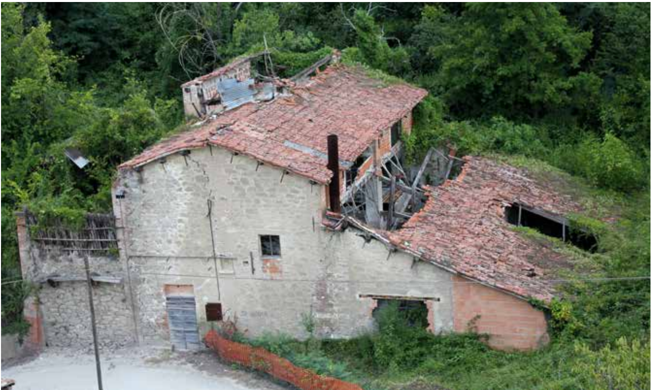
Fig. 40 – La fornace di proprietà Malpezzi costruita nel 1926 e attiva sino al 1969, oggi in stato di estremo degrado (foto S. Piastra). Il corpo di fabbrica centrale, più alto e dotato di ciminiera, ospitava il forno per la cottura del gesso; nella parte di sinistra era ubicato il frantoio per la frantumazione del minerale; la parte di destra, caratterizzata da una lunga falda, fungeva da magazzino per gli attrezzi. Il gesso polverizzato fuoriusciva attraverso le due buchette metalliche visibili nel corpo di fabbrica di sinistra, andando a caricare dapprima i birocci, successivamente gli autocarri, che si posizionavano immediatamente al di sotto. L'opificio lavorò in massima parte gesso estratto nella cava Marana, aperta dai Malpezzi nel 1929.
