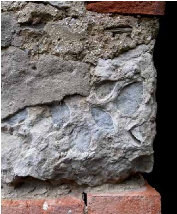
Fig. 14 – Blocco lavorato di calcare a Lucina utilizzato nella muratura di Ca' Ronco (foto M. Sami).
