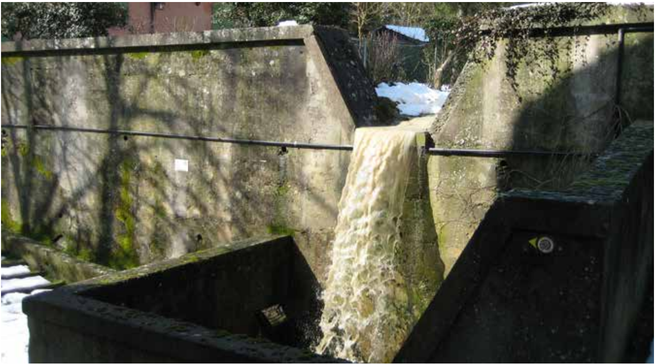
Fig. 24 – Il Rio della Valle in piena in seguito allo scioglimento delle nevi (6 marzo 2011). L'immagine ritrae la briglia in cemento a salto unico costruita nel 1939 a protezione dell'imboccatura del tombamento del corso d'acqua (foto S. Piastra).
